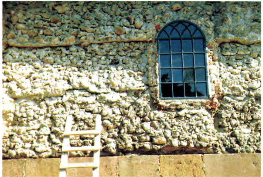
Omsætning af sydmur. Det ses, at opfyldningen af kassemuren i sin tid er sket etapevis. Vroue Kirke. (Foto: Forfatteren).
