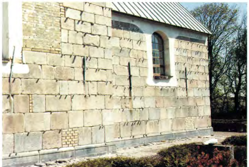
Slutfase i omsætning af en sydmur. Trækilerne anvendt ved murrearbejdet kaster slagskygger på væggen i det stærke sollys. Rakkeby Kirke. (Foto: Forfatteren).
